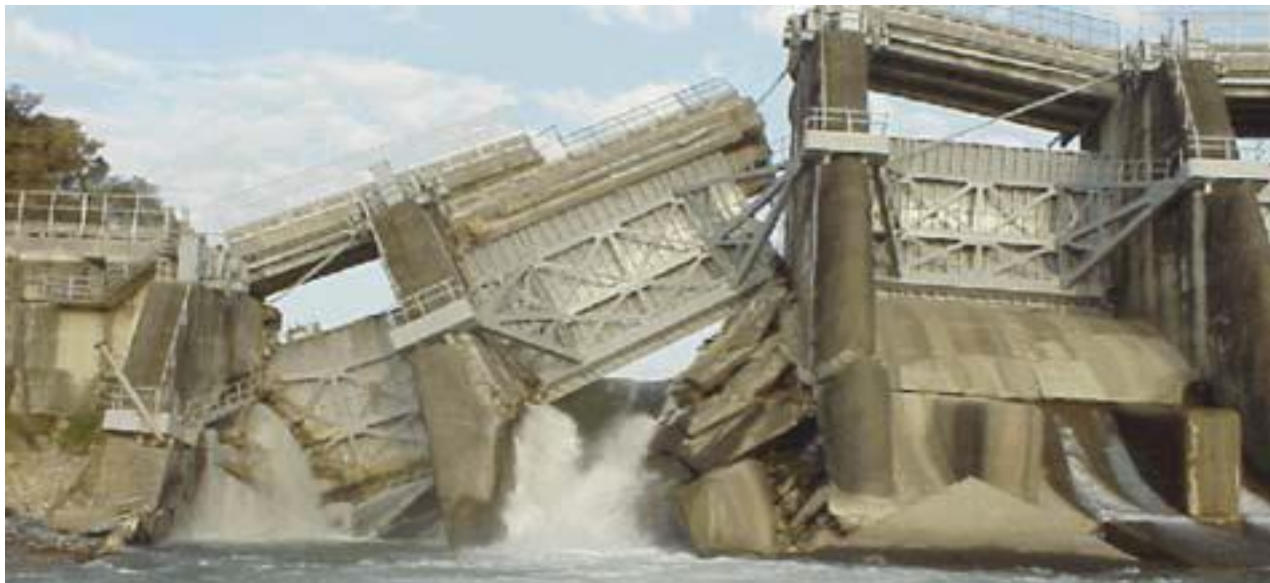
Рис. 2. Разрушение плотины Ши-Кань на Тайване во время землетрясения Чи-Чи 21.09.1999 г. [2]
