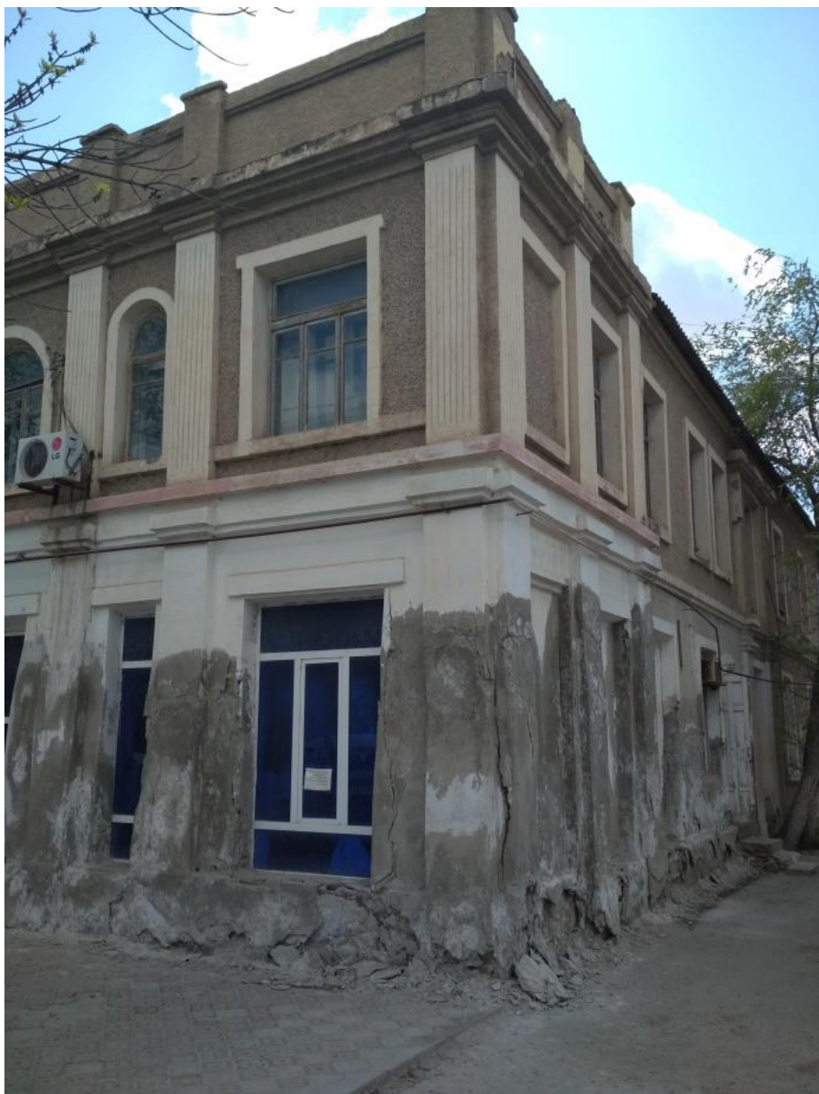
Рис. 2. Характер разрушения здания по ул. А.Шамуратовой в г. Нукусе (2018 г.)
